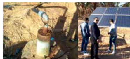
Sistema de bombeo solar gracias al nuevo producto SIPS.
